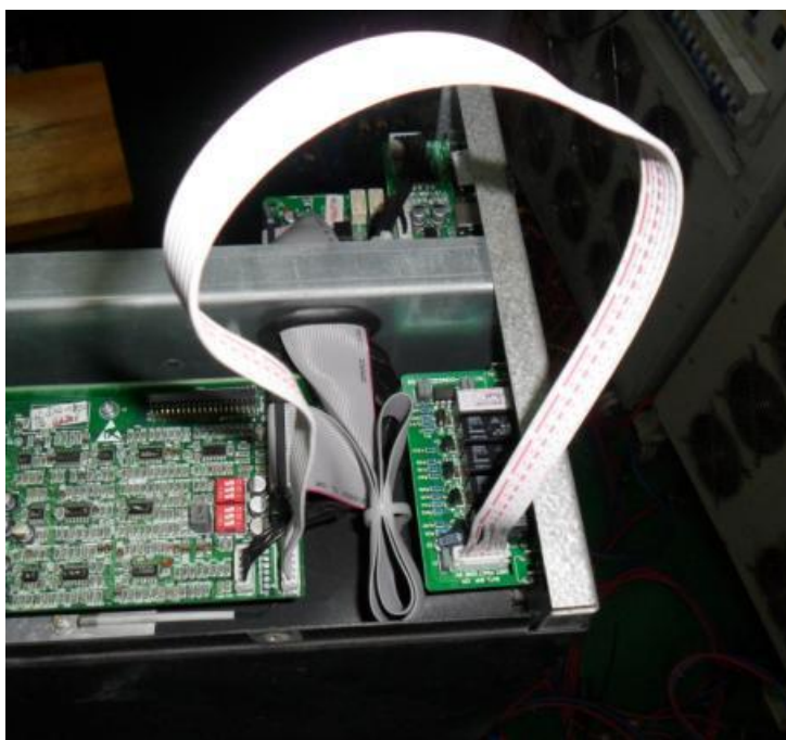
Widok instalacji karty AS400 /" DRY contact" w KR 6/10 kVA
